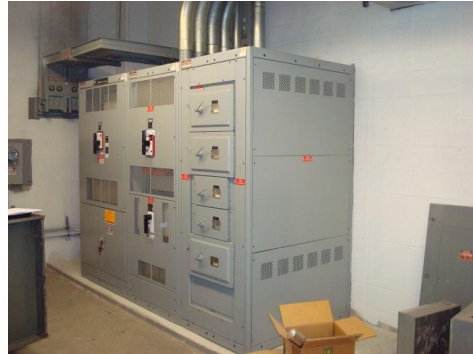
MDP-2L (Sub-Basement Electrical Room)
